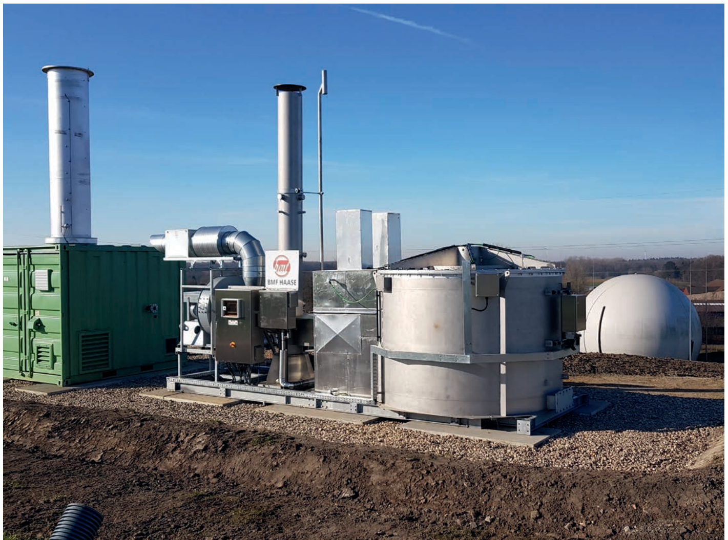
Schwachgasfackel (links, grün) und regenerative thermische Oxidation (RTO, rechts)
